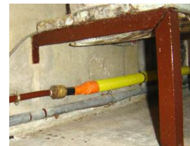
Exemple d'anomalie de PE qui pénètre dans l'habitation
