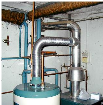
Exemple de tronçon commun comportant plusieurs anomalies.
