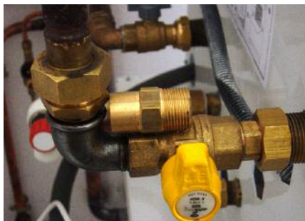
Exemple d'assemblage où des raccords mécaniques sont trop nombreux. Le raccord posé au-dessus aurait dû être utilisé
